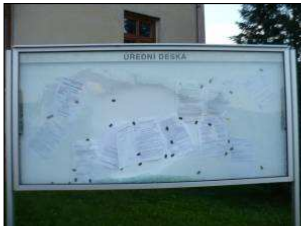
Poškození úřední desky u OÚ
