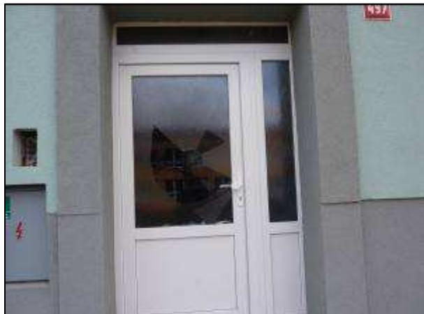
Poškozené sklo na dveřích domu č.497
