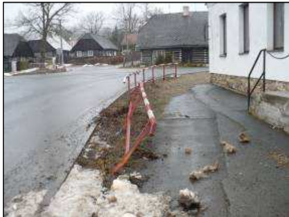
Poškozené zábradlí u křižovatky Libuše
