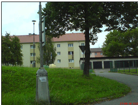
poškozená fasáda domu č.464
