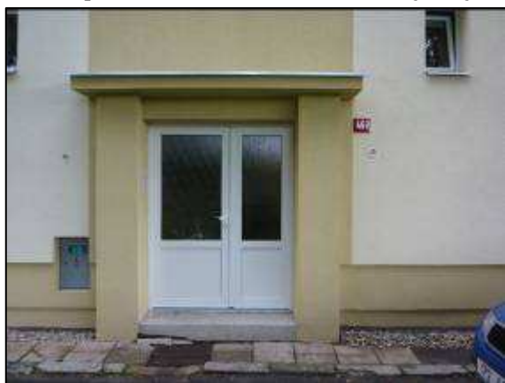
rozbité sklo –dům č.457
