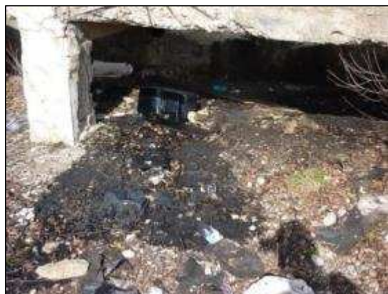
Kasárna –rampa (olej, filtry )
