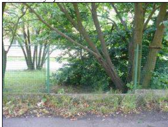
Vandalství –poškození plotu u školy
