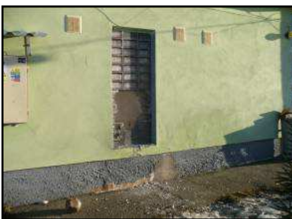
Poškození a vniknutí do objektu benziny.
