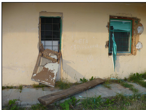
Vloupání do objektu „Koupák“
