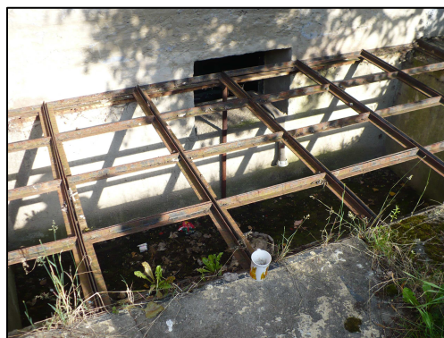
Krádež železných roštů – kasárna
