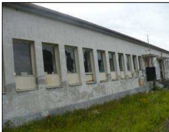
Rozbitá okna budovy č.19
