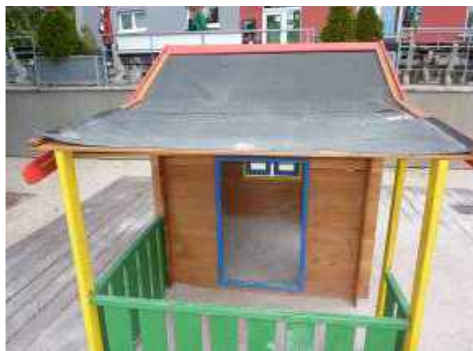
Střeška nového dětského domečku je již poškozena
