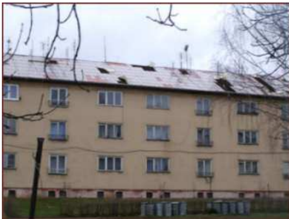
Západní strana nájemního domu čp. 450 – 451, střecha poškozená vichřicí.
