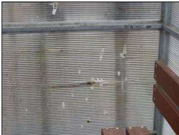
Propálené stěny u zastávky na Huti.
